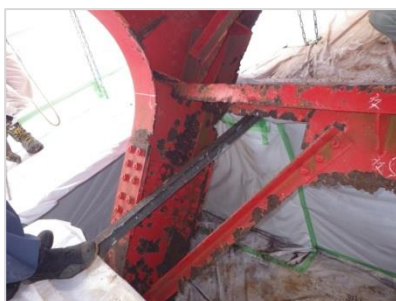
鋼製脚の腐食・ストラッドの腐食
